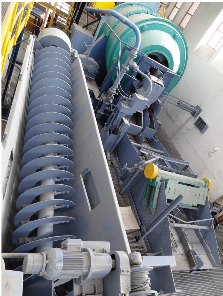
Abb. 9: Schwertrübeanlage WEMCO in der Zentralaufbereitung Antoni. Im Vordergrund ist der Schraubenklassierer für die Schwertrüberegeneration dargestellt.
